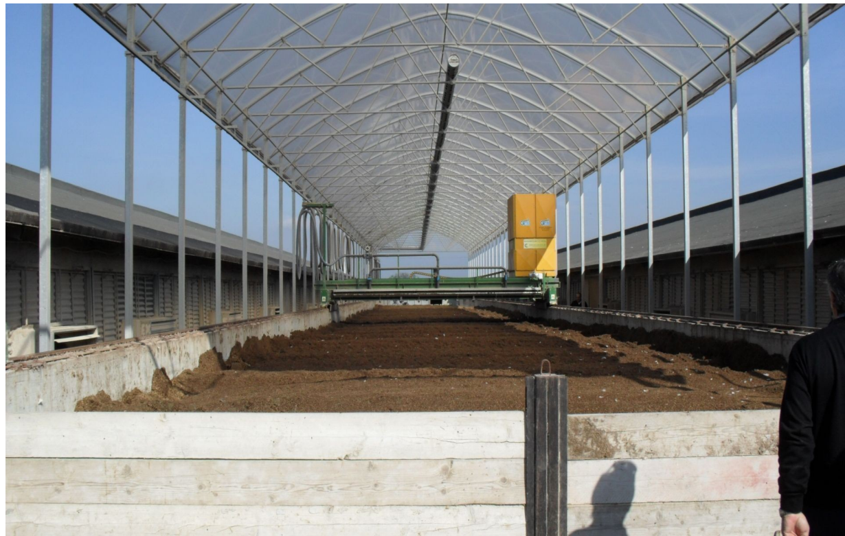
Bioessiccazione a tunnel aerato-riscaldato Fonte: Candiracci
