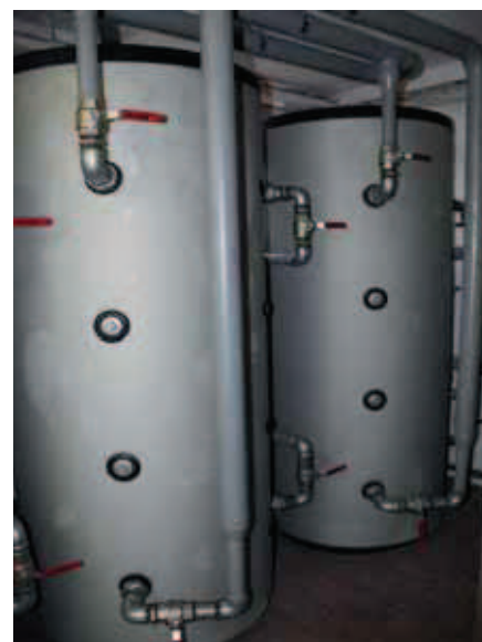
Due dei 3 accumulatori inerziali da 1.000 L ciascuno
