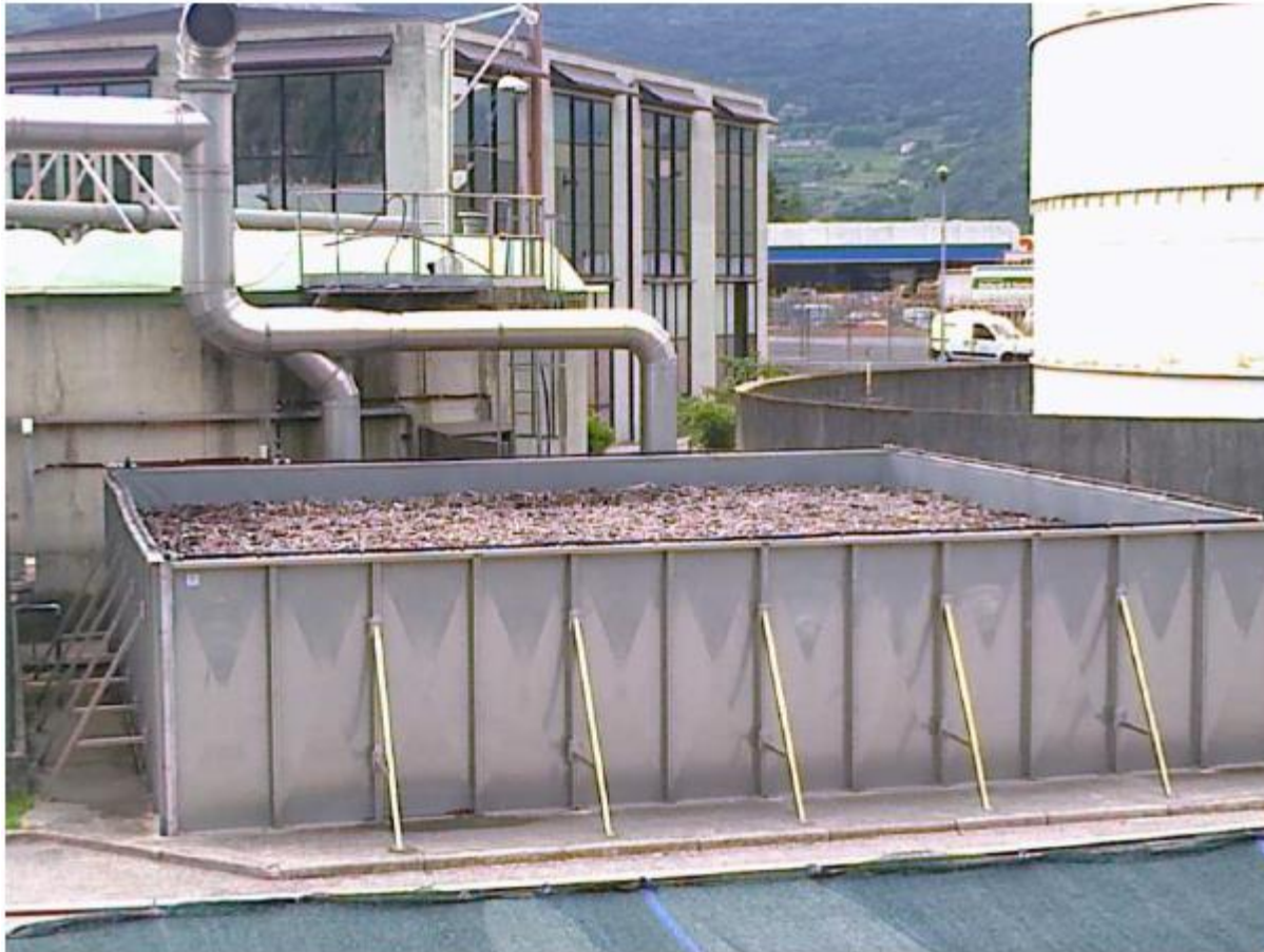
Trattamento aria in doppio scrubber acido-base e biofiltro
